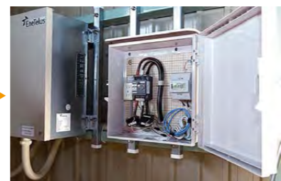
エネルギーマネジメントシステム (EMS) 計測器。事務所のエアコンを自動でコントロールし、省エネに役立ちます。災害時など太陽光発電の自立運転時には左のコンセントから電気を供給できます。
