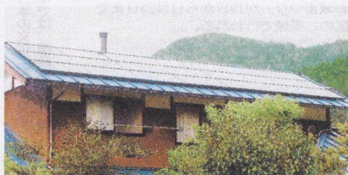
カフェの屋根に設置された太陽光発電パネル(南丹市美山町内久保)
