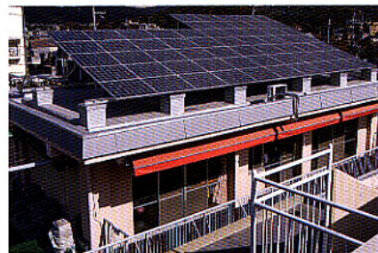
園舎の屋上に設置された太陽光発電パネル
