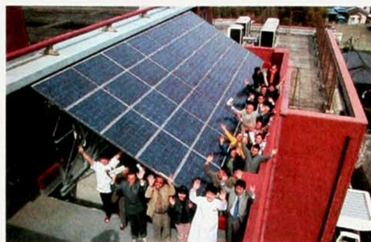
熊本市の北部病院屋上に設置された「かんくまおひさまプロジェクト」第一号(かんきょうネットワークくまもと提供)
