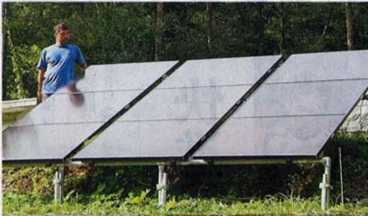
太陽光発電のパネルを設置した田歌舎の藤原さん（南丹市美山町）
