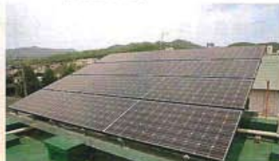
妙林苑(保育園)の屋上に設置された 10kWの発電規模を持つソーラーパネル
