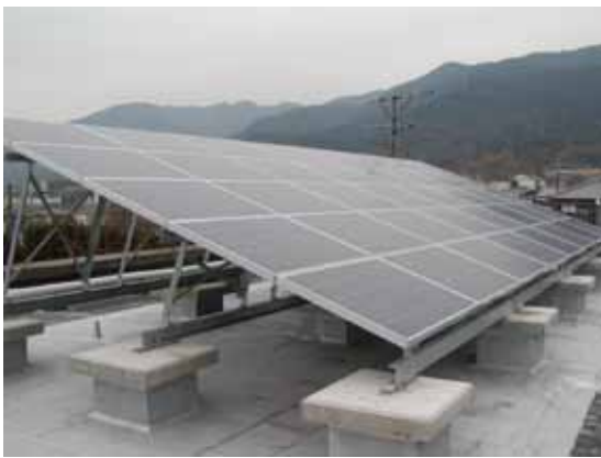
陸屋根に設置した太陽光パネル 基礎や防水工事も大切です。
