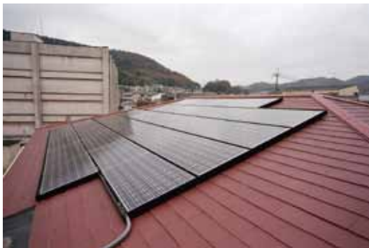
屋根の材質なども考慮に入れ、 傾斜のある屋根にじかに設置した例
